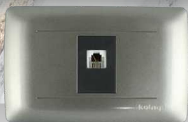
3408-29 TOMA DE TELÉFONO
