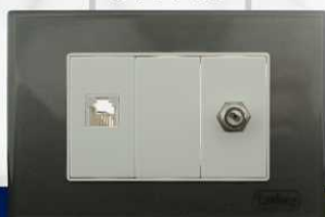
TOMA DE TV + TELÉFONO
