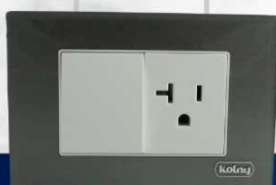
TOMA INTERRUPTOR DE 20A
